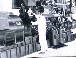
Gas Turbine 625kVA.
